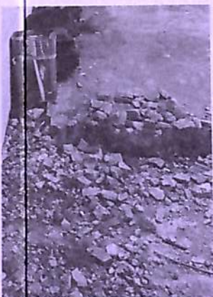
▶工場時代の基礎がポロポロになっただまが残っています
